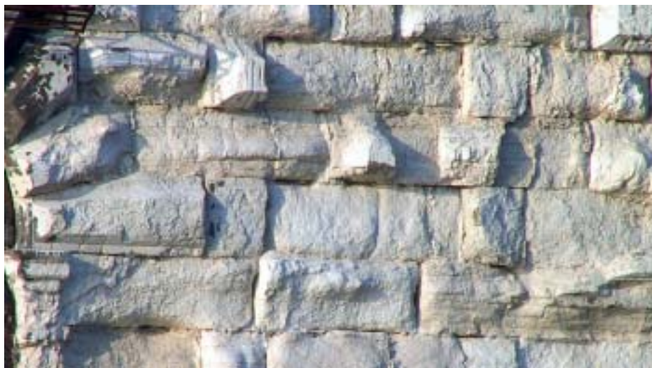
Stato pietoso del bugnato di Palazzo Michiel sul Canal Grande
