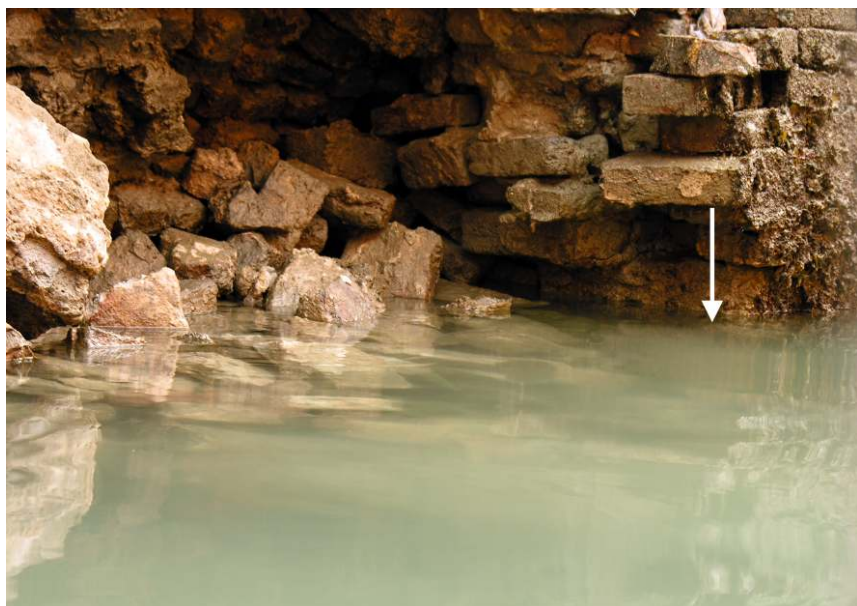
Crollo della Fondamenta sul rio del Tentor (Dorsoduro)
